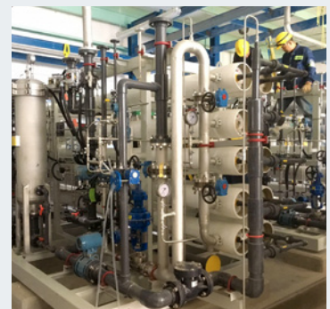
グループ会社の工場の水処理装置
