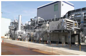
東レ(株)三島工場のコジェネレーション設備
