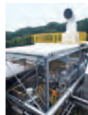
東レ(株)岐阜工場のボイラー
