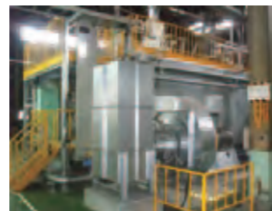
東レ(株)岡崎工場のボイラー
