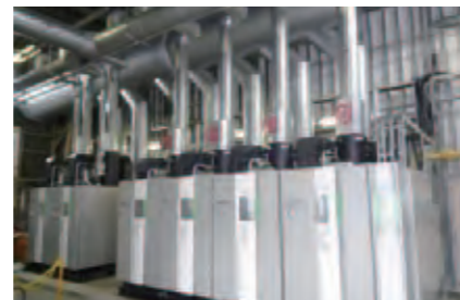
東レ(株)石川工場に設置したガスボイラー
