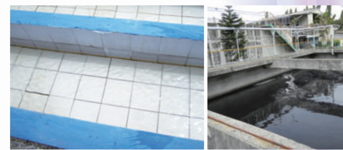
排水処理設備の水路に白いタイルを使用し(左)、排水の色で異状を確認
