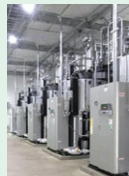
東レ(株)土浦工場に設置したガスボイラー
