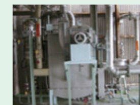
東レ(株)千葉工場に設置した排ガス処理装置
