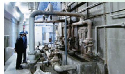
省エネ診断時現場確認の様子 (大垣扶桑紡績(株) 大垣工場)
