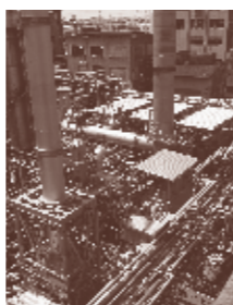
名古屋事業場のコジェネレーション設備
