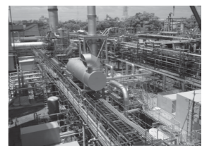
名古屋事業場のコジェネレーション設備
