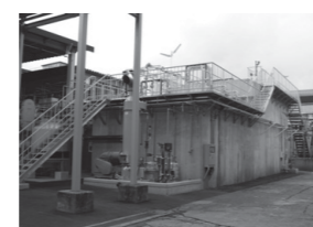
滋賀事業場の新設 MBR 処理設備
