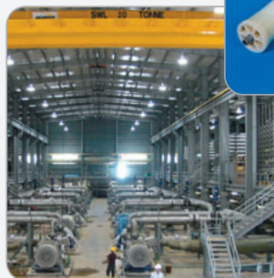
環太平洋最大のシンガポール・チュアス地区海水淡水化プラントの内部写真 (提供：Hyflux社様)
