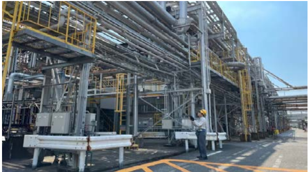
頭上高く設置された配管
