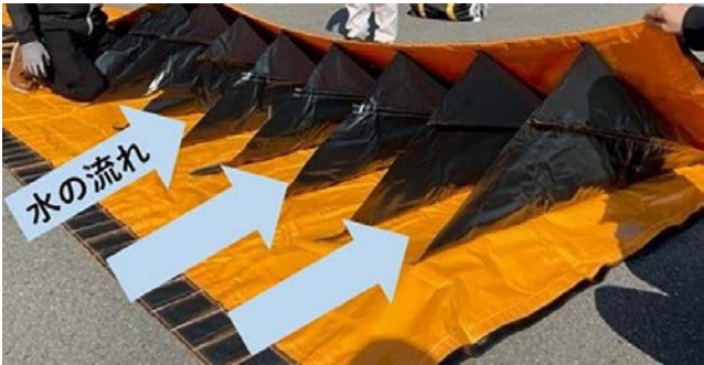
ウォーターゲートの設置
