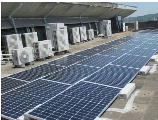
東レ（株）基礎研究センター（鎌倉）の太陽光発電設備
