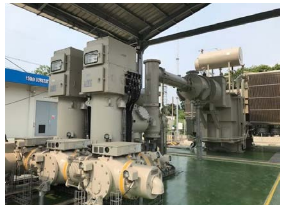
P.T. Indonesia Toray Syntheticsの受変電設備
