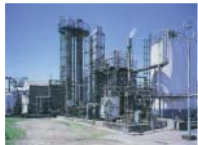
東レチオコール社の千葉工場における排水処理設備
