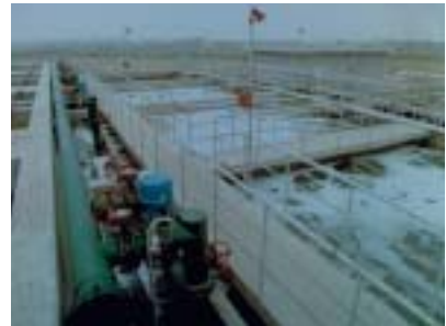
中国、東麗酒伊印染(南通)有限公司における最新鋭の排水処理設備
