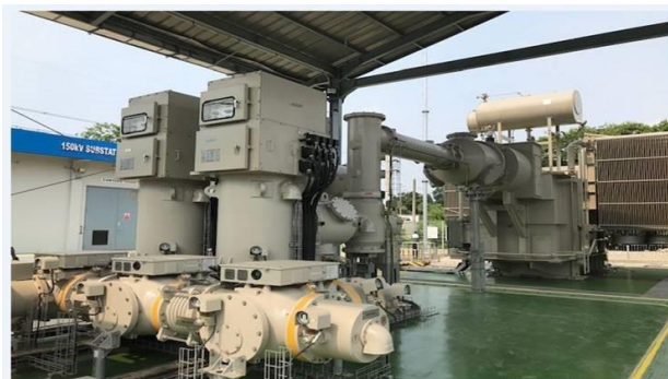
買電化に向けて新たに導入した設備（受変電設備）
