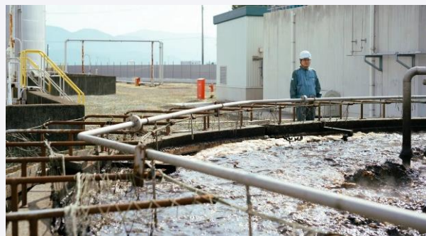
活性汚泥法で行う排水処理
