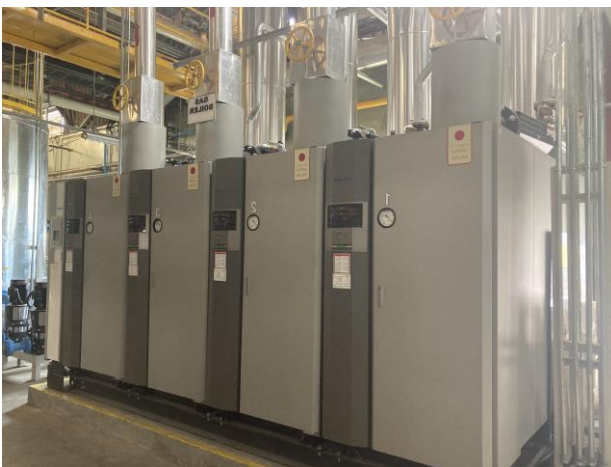
燃料転換に向けて新たに導入した設備（ガスボイラ）
