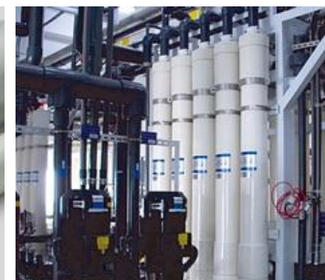
水処理膜装置
