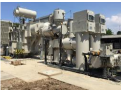
ITS受変電設備
