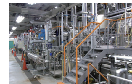
医薬品製造プラント Pharmaceutical Manufacturing Plant
