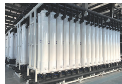
Toray UF を使用した廃水処理プラント Wastewater Treatment Plant using Toray UF
