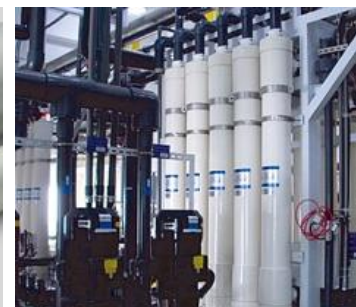
水処理膜装置
