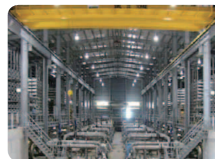
チュアス海水淡水化プラント内部
