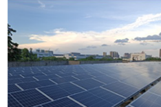
2020年度に太陽光発電設備を導入したTPPZ
