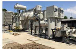
ITS受変電設備
