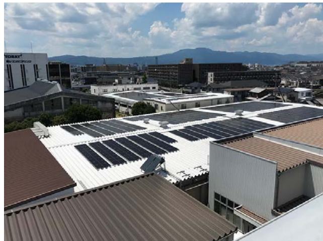
東レ・プレジジョン（株）の太陽光発電設備
