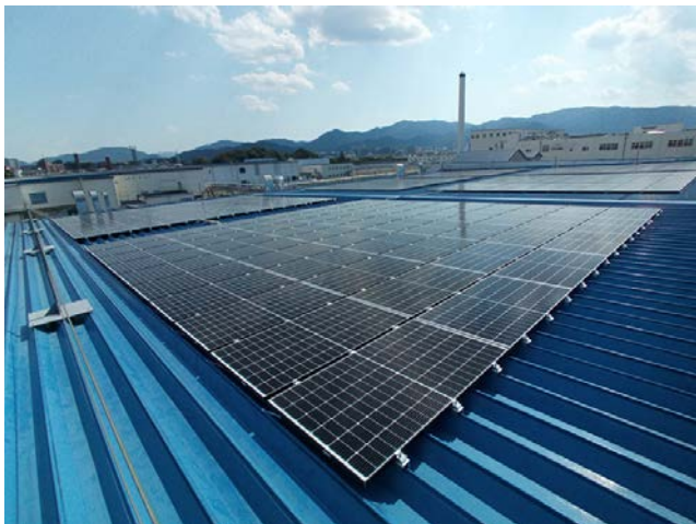
東レ（株）瀬田工場 第3工場の太陽光発電設備
