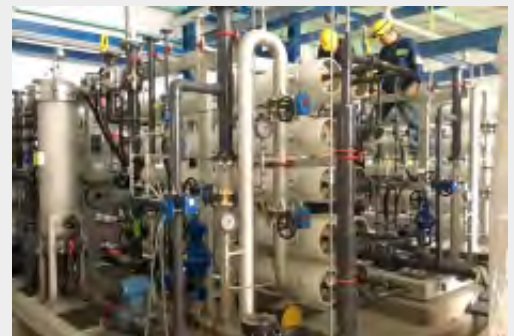
グループ会社の工場の水処理装置
