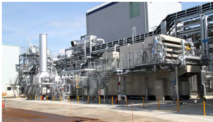
東レ(株)三島工場のコジェネレーション設備
