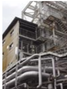
三島工場の天然ガスボイラー
