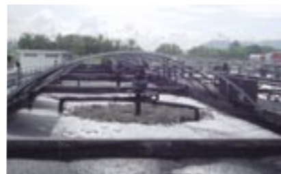
排水処理設備 (ペンファブリック 第4工場)
