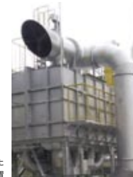
東レフィルム加工に設置した有機系排ガスの蓄熱式燃焼装置
