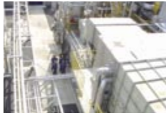
ガスコジェネ設備 (滋賀事業場)
