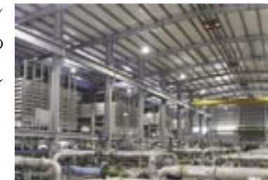
環太平洋最大の海水淡水化プラント チュアス浄水場(シンガポール) 写真提供:Hyflux社
