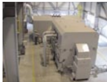
蒸気タービン発電機
