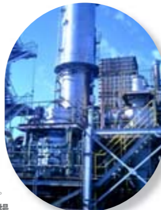
東海工場のN 2 O熱分解設備
