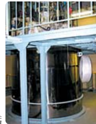
東レ愛媛工場に設置した有機系排ガスの蒸留回収装置
