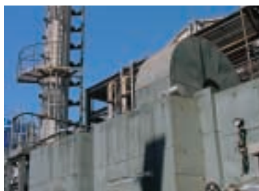
東海工場プロセス脱硝設備
