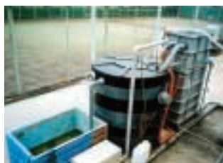
東レ・モノフィラメント(株) MBR(メンブレンバイオリアクター) パイロット試験設備
