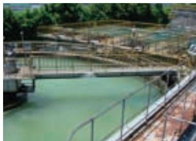
岡崎工場排水処理設備
